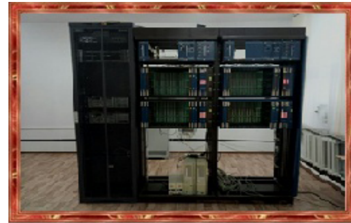
Рисунок 2- Цифровая автоматическая телефонная станция DRX-4
